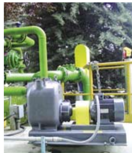
Zelfaanzuigende centrifugaalpomp in de waterzuivering.
